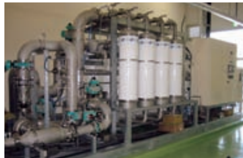
新工場棟の「工水浄化システム」
